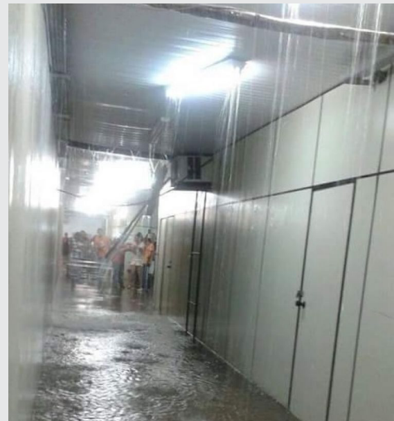
Corredor do campus da UFMT em Rondonópolis alagado pela chuva. Março de 2015.
